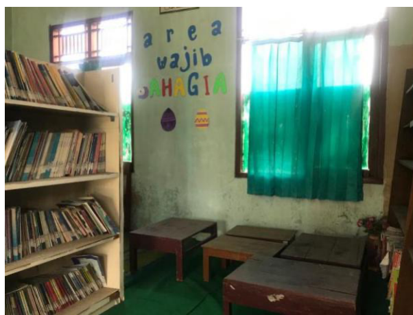
Gambar 1. Kondisi Perpustakaan Sebelum di Perbaiki
