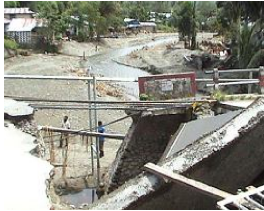
Gambar 2b. Kerusakan jembatan akibat Banjir dan erosi
