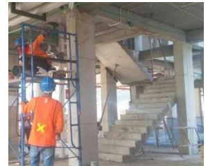
Gambar 9. Rcn. tangga darurat (sumber: Dok. Survei, 2020)
