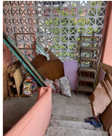
Gambar 12. Kondisi Lorong Sirkulasi Blok E (Sumber: Dokumentasi Penulis, 2022)
