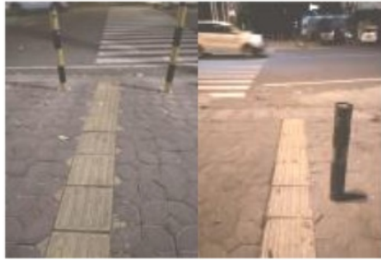
Gambar 11. Ujung jalur pemandu yang tidak diakhiri dengan ubin peringatan (sumber: Dokumentasi peneliti, 2018)
