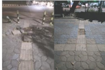
Gambar 12. Jalur pemandu yang mengalami kerusakan akibat kendaraan bermotor yang melintas di atas city walk (sumber: Dokumentasi peneliti, 2018)
