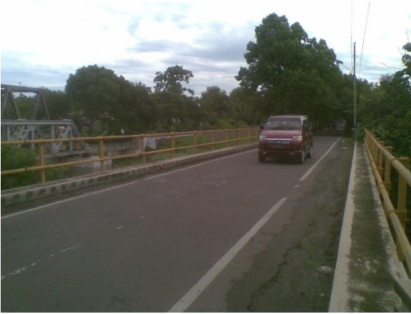
Gambar 19. Kondisi Fisik Jembatan di Jalan Diponegoro Sumber: Survei, 2013
